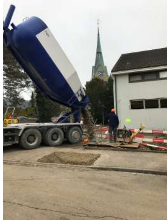
Geröll auffüllen / stillgelegter Öltank
